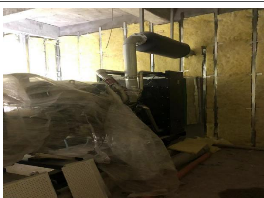
风机房墙面吸声材料
