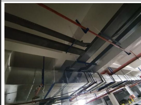
地下车库排风系统
